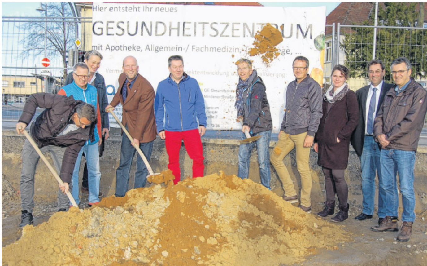
Der Sand fliegt: Zum symbolischen ersten Spatenstich trafen sich Investoren und Mieter auf der Baustelle.
