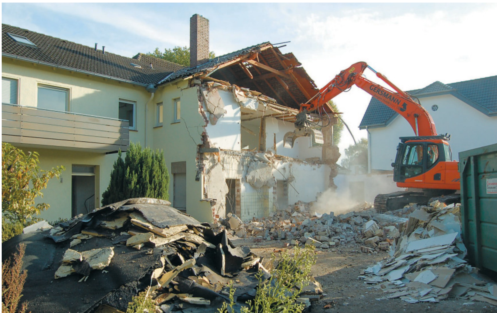
Wand für Wand: Von Süden her wird das Geschäfts- und Wohnhaus Stück für Stück abgerissen. Als letztes wird die Fassade zur Mindener Straße (B 65) hin dem Erdboden gleichgemacht. Die unterschiedlichen Baustoffe werden getrennt. FOTO: SANDRA SPIEKER
